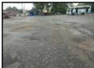
Gambar 9. Kondisi perkerasan di Terminal Kp. Keramat
