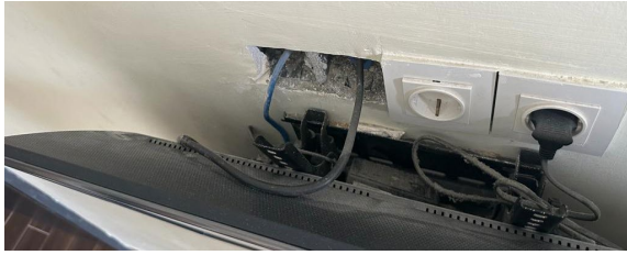
Gambar 4. Kerusakan Komponen Elektrikal
