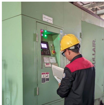
Gambar 5. Pengambilan data tekanan dan temperatur keluar kompresor
