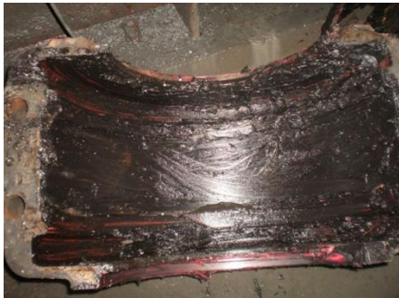
Gambar 9 Kondisi bantalan yang masih terisi pelumas
