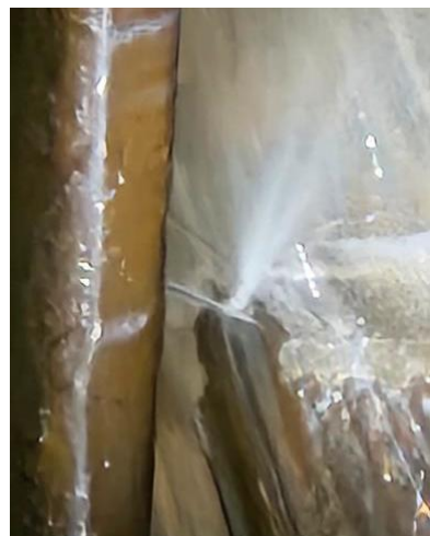
Gambar 1 Kondisi kebocoran pada riser wall tube
