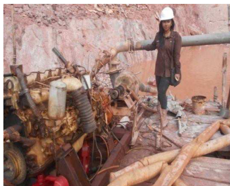
Gambar 5. Kondisi pompa aktual
