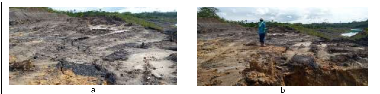
Gambar 4. Kondisi batuan : (a) lereng sidewall yang mengalami rekah tarik, dan (b) slope cut di sidewall
